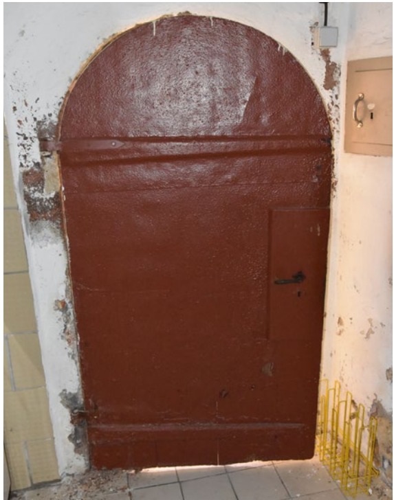
Abbildung 44: Eisenbeschlagene „Brandschutztür“ zum Nebengebäude vor Instandsetzung
