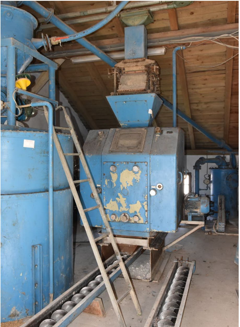
Abbildung 9: Heute erhaltene technische Ausstattung im Dachgeschoss des Sudhauses
